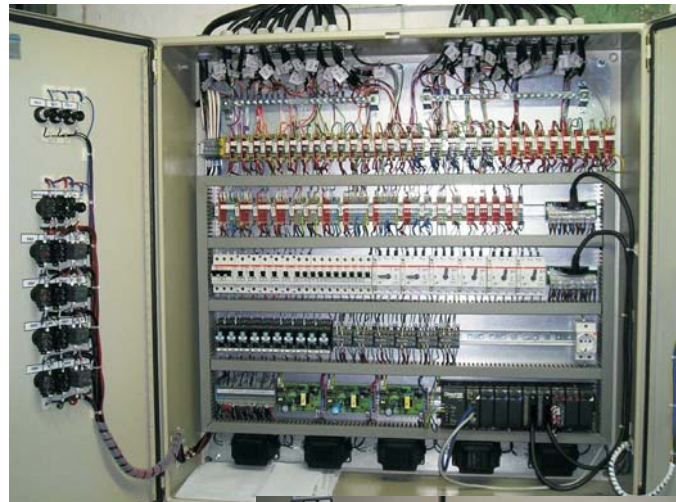
Щит управления вспомогательным оборудованием
