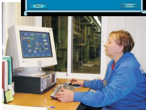
АРМ оператора с установленной SCADA-системой
